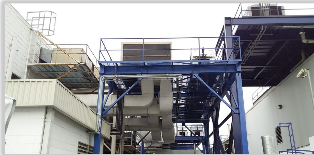
Instalación de equipos de aire acondicionado tipo paquete
