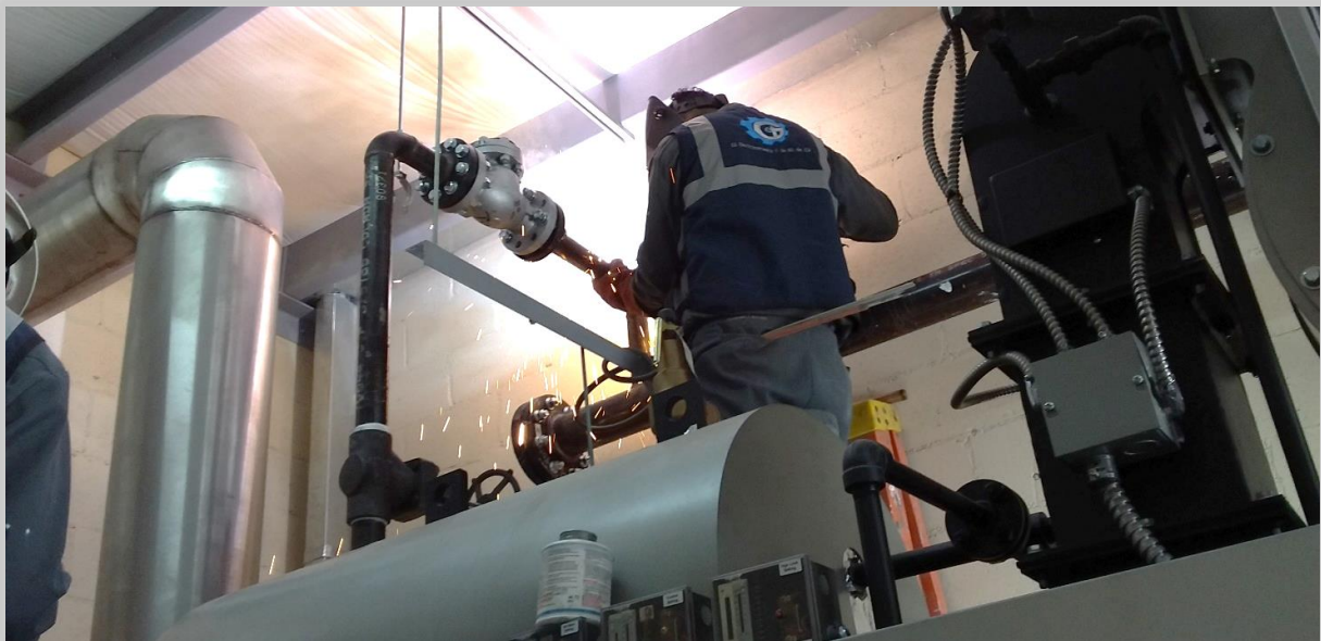
Armado de cabezal de vapor
