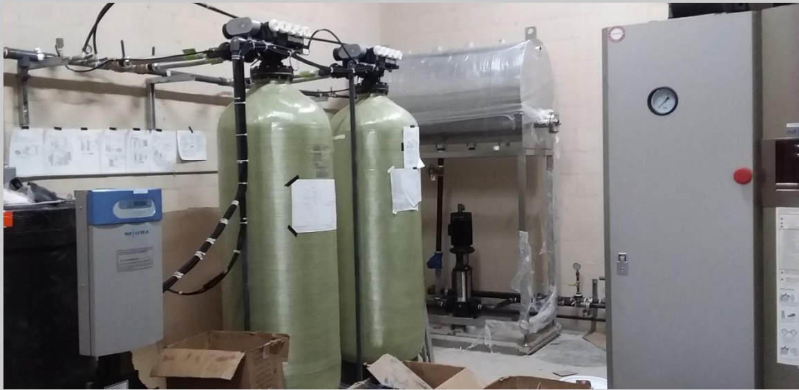
Instalación de sistema suavizador de agua, tanque de condensados para suministro de caldera
