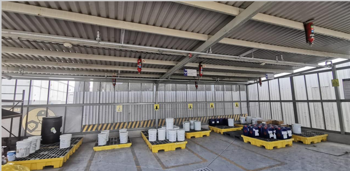
Sistema abierto de rociadores espuma contra incendio
