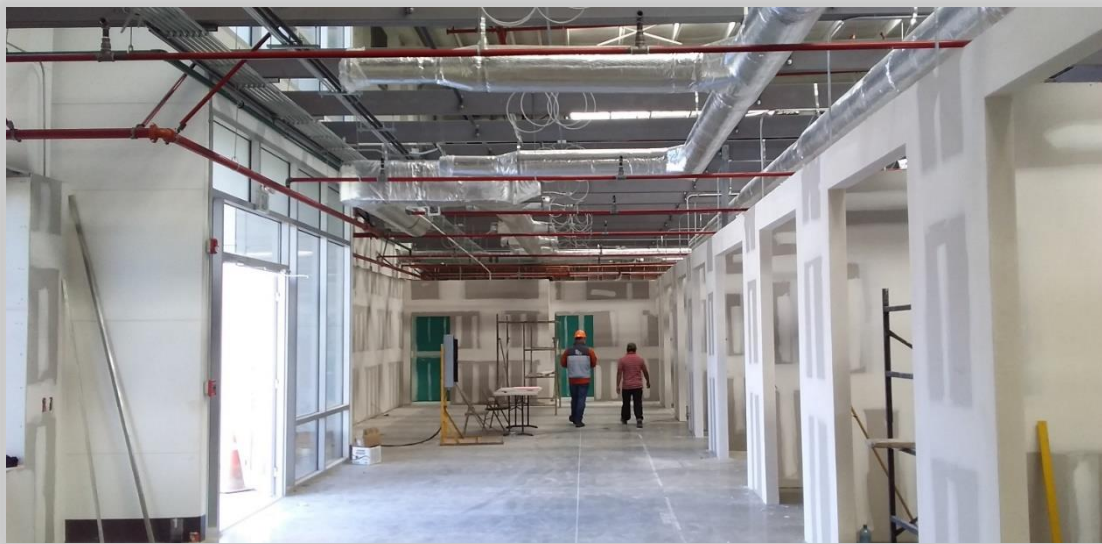
Sistema de rociadores para oficinas
